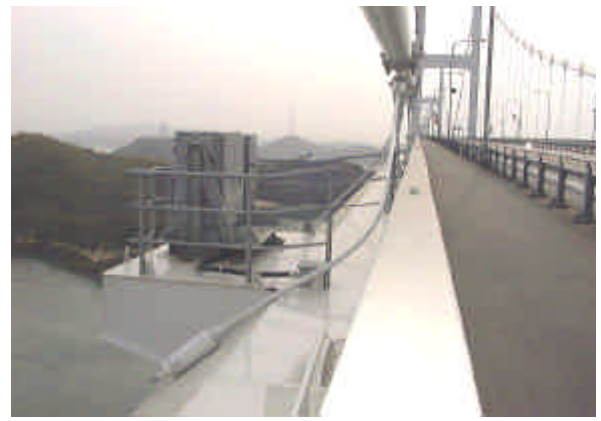
センターステイロッドの破断 (Failure of the Center Stay Rod)
