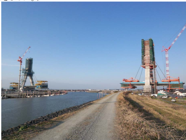
写真-4 矢部川橋の上部工架設状況全景 (矢部川下流側より)
