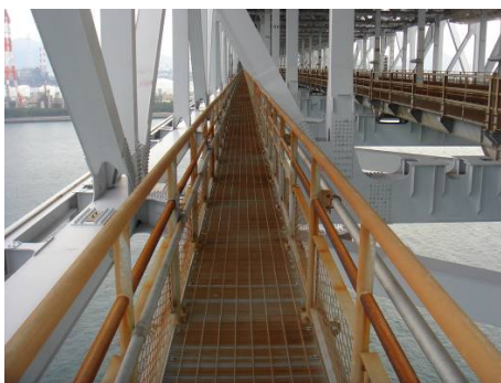
写真-4 管理路劣化状況
