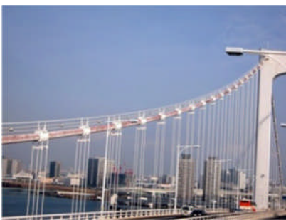
写真-2 主ケーブル劣化状況 Photo.2 Deterioration of main cable
