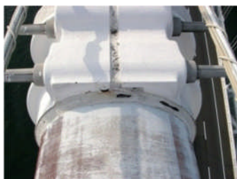
写真-3 コーキング劣化状況 Photo.3 Deterioration cable band caulking
