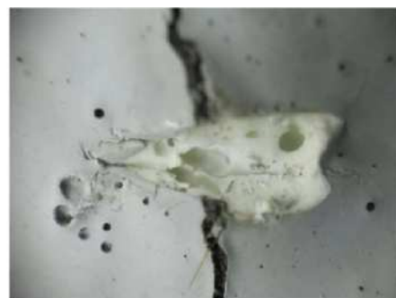
写真-2 塗膜内部の状態観察
