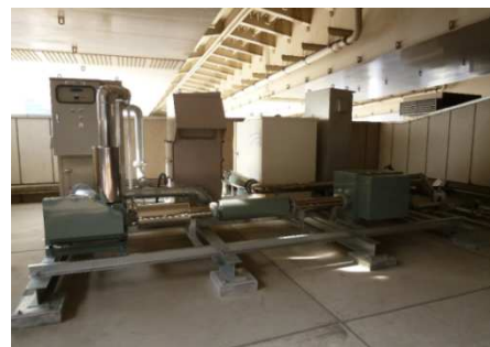
写真-4 乾燥装置 Photo.4 Dehumidifier
