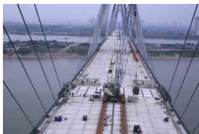
写真-1 最終閉合作業状況【P15～P16間】 Photo 1 Final Closure Works between P15 & P16
