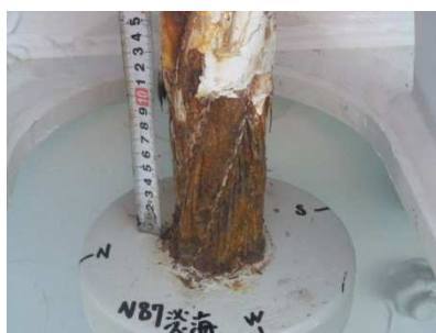
写真-1 取替ハンガーロープ定着部の腐食 Photo 1 Corrosion at Anchor Parts
