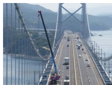
写真-2 ハンガーロープ取替え状況 Photo 2 Replacement of Suspender Ropes
