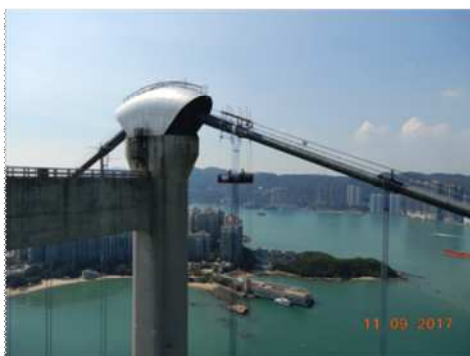
写真-10 ゴンドラによるハンガーロープアクセス Photo 10 Gondola at Suspender
