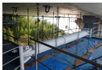
写真-1 制震ダンパー
