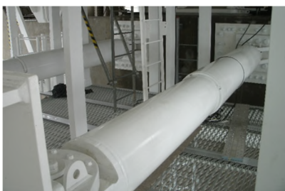
写真-7 制振ダンパー全景 Photo-7 Damper installed
