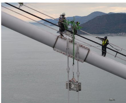
写真-1 北備讃瀬戸大橋の調査 Photo-1 Test in the Kita Bisan-Seto Bridge
