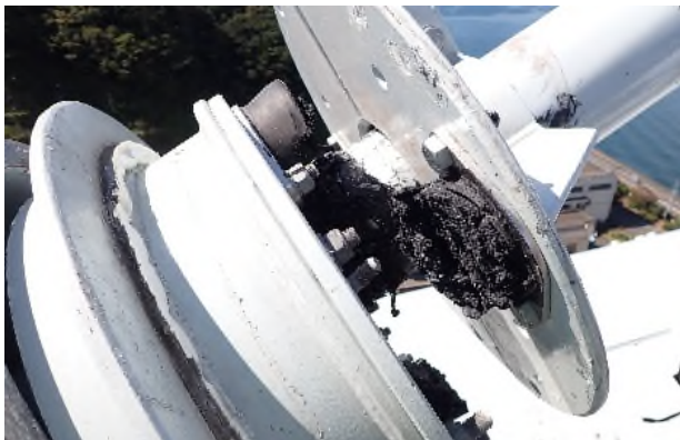
写真-3 制振ダンパー破断状況 Photo 3 Rupture of Rubber Damper
