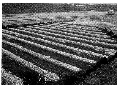
写真-2 集水装置の内部 (砕石と特殊土壌) ・土壌底部に集水のパイピングがしてある。
