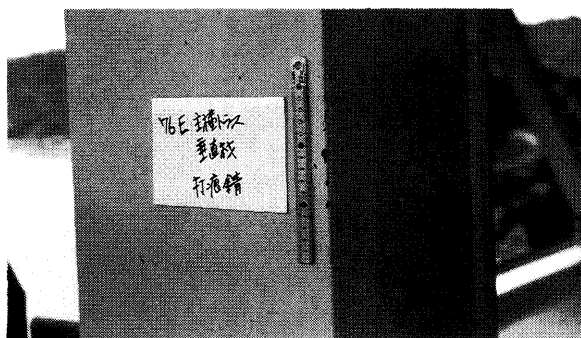
写真-8 打痕による部材エッジ部の錆
