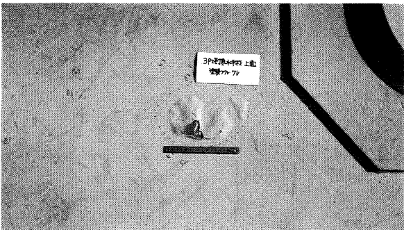
写真-21 施工不良による塗膜のふくれ
