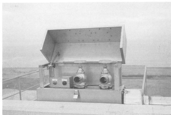
番の州高架橋給水栓
