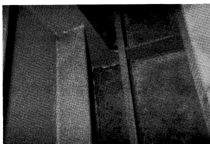
写真-4 塔頂水平材下フランジの腐食
