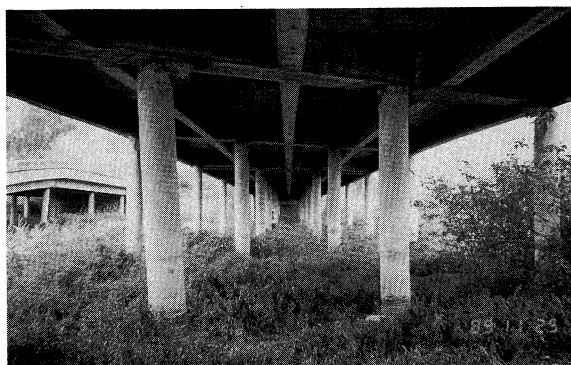
写真-19 杭が横桁に直接取り付けられている。何本かの杭は横桁との取り付け部でズレを生じている。
