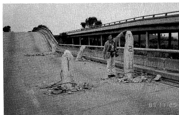
写真-20 地上まで落橋した箇所で、4本のパイルベントが床版を突き抜け、約1.2~1.8m飛び出している。他に数本の杭が、床版の鉄筋に当たり突き抜ける寸前であった。
