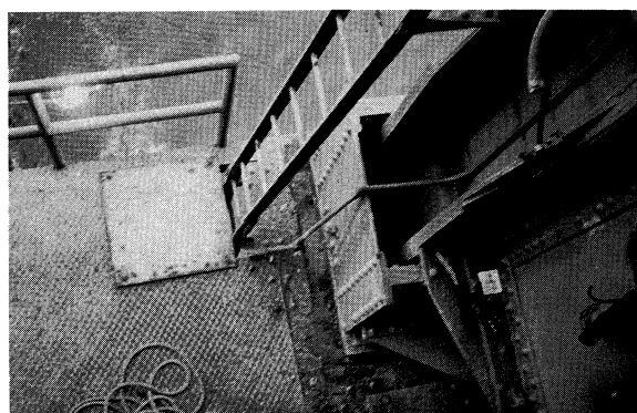
写真-6 E9橋脚上のオークランド側トラスト桁の連結ボルトが切断し、支点部が右側（東側）へずれたのがわかる。（CALTRANSによる）
