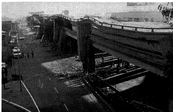
写真-17 サイプレス高架橋の被害状況。32番通交差点部の高架橋の崩壊状態の写真で、右側がI-80号線とのインターチェンジになる。完全に上層の桁が下層の桁まで崩落している。橋脚はヒンジの位置がタイプ1のもので、図6.4-18に示す崩壊状態通りであるのがわかる。
