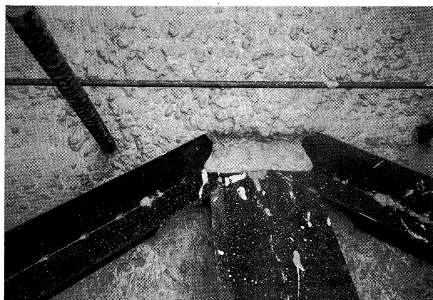
写真-2 鋼材周りの流動状況
