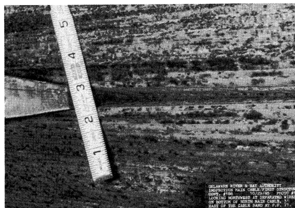
写真-26 クサビ調査 ケーブル下側 腐食有(第1デラウェア・メモリアル橋)
