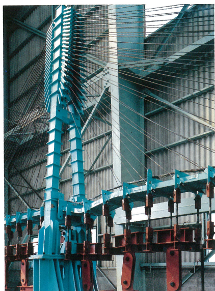
座屈全体状況
