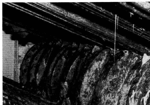
写真-8 重質のグリース塗布 水を溜め腐食要因となっている（ウィリアムズバーグ橋）
