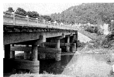
写真-1 洪水などによって引き起こされた洗掘
