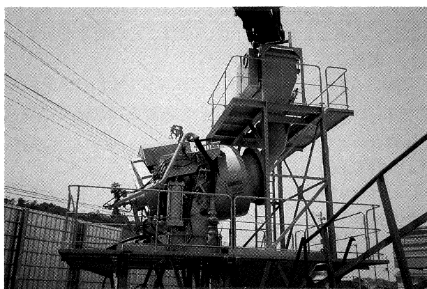
写真-1 サンドスタビライザーの設置状況
