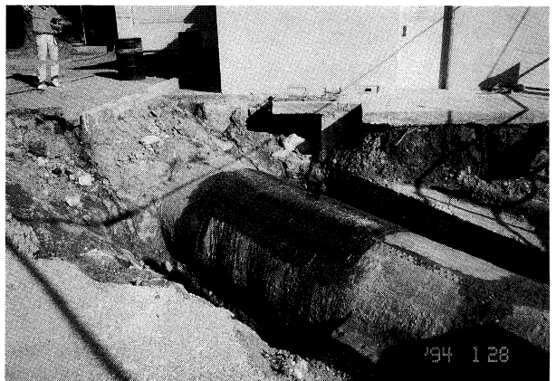
写真-17 リベット造り水道管の破断。破断箇所は補修済みである
