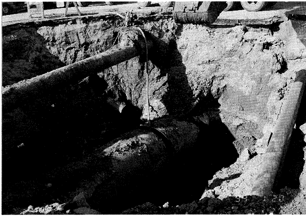
写真-14 上; ガス本管、下; 水道管。特にガス管の土被りが薄い。
