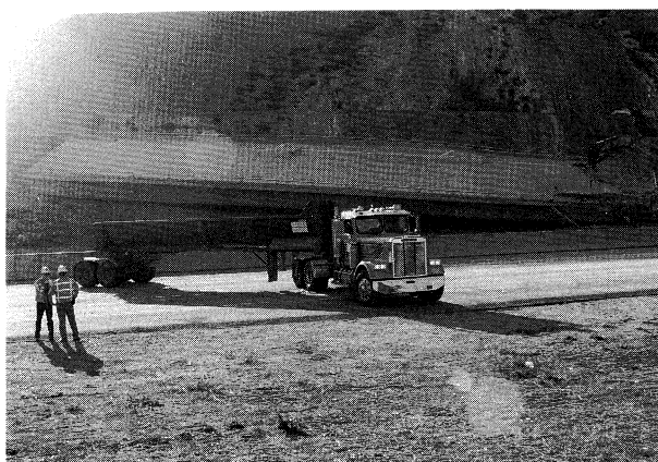
写真-10 S-14の落橋桁。桁の右端では2台のブレイカーが桁を破砕しており、手前の大型トレーラーで搬出す
