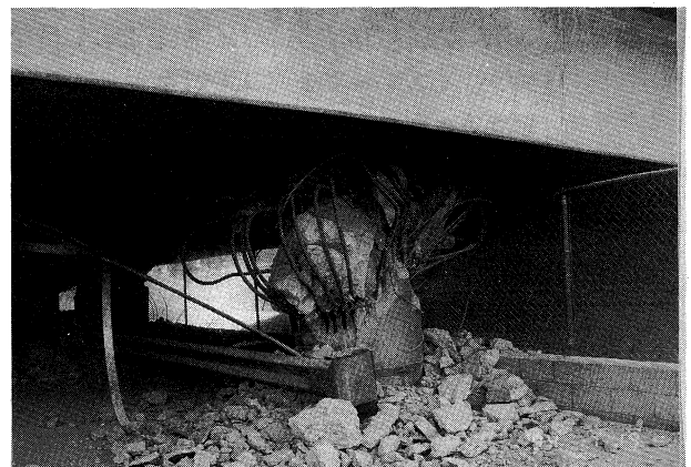
写真-1 I-10・フェアファックス・ワシントン地区橋梁の橋脚圧壊状況
