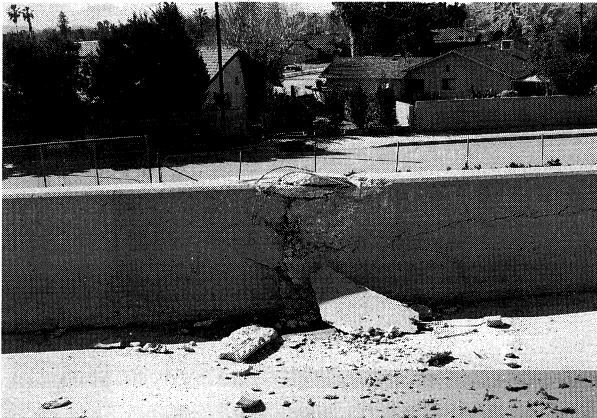
写真-7 自動車防護壁の破壊
