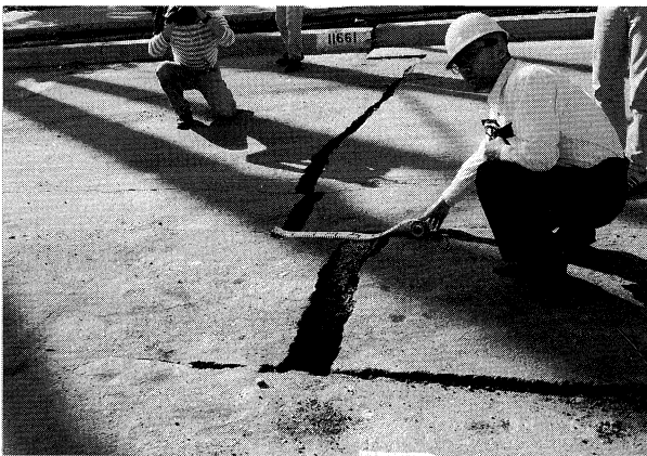
写真-15 舗装面のひび割れ、最大ひび割れ幅は約20cm
