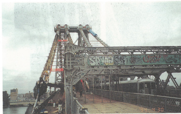
写真-2 マンハッタン側歩道部より望む 補修は道路、鉄道を 供用しながら行っている。落書きが非常に多い Photo.2 Scene from sidewalk on Manhattan side-Repair works use road and rail. Graffiti is seen here and there
