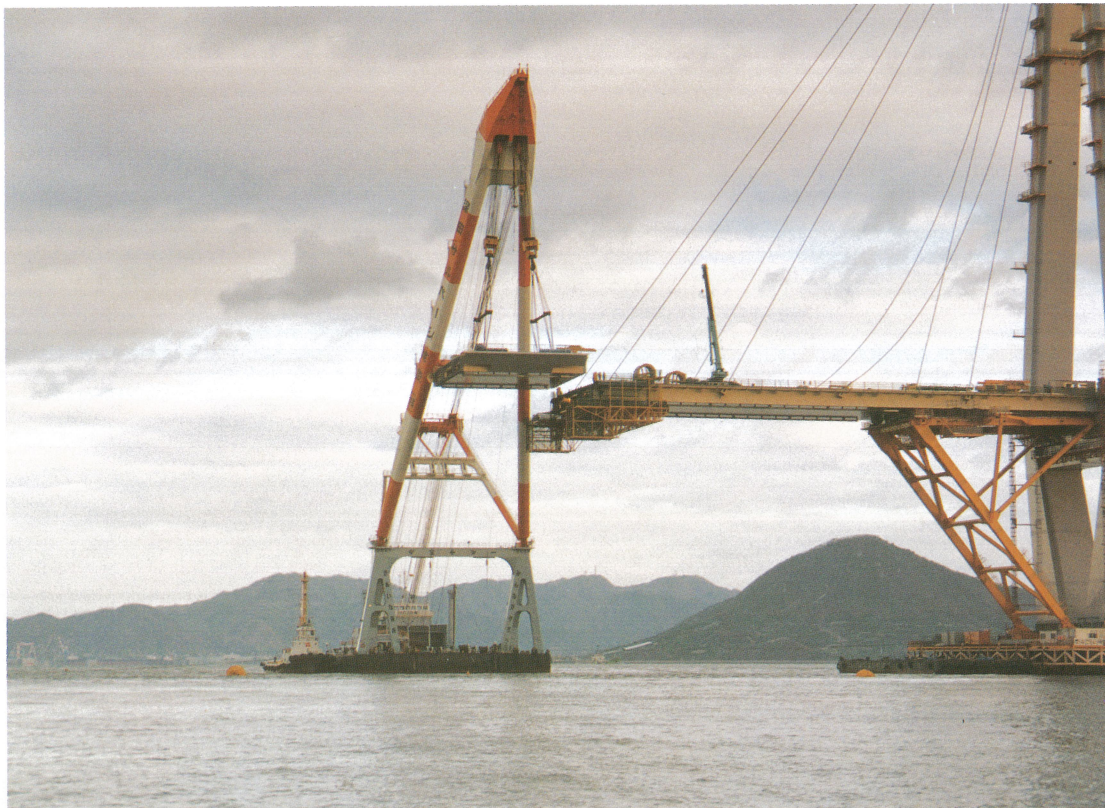
多々羅大橋 3P [側径間 FC 小ブロック架設] Tatara Bridge 3P—erection of the side-span block by floatation crane
