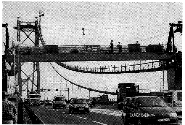
写真-4 新設された側塔の横梁 Photo.4 Lateral beam on new side tower
