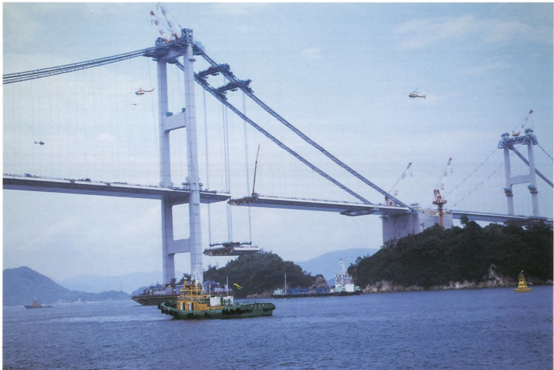
来島大橋補剛桁最終ブロック架設状況 Kurushima Bridge — erection of last block for stiffening girder
