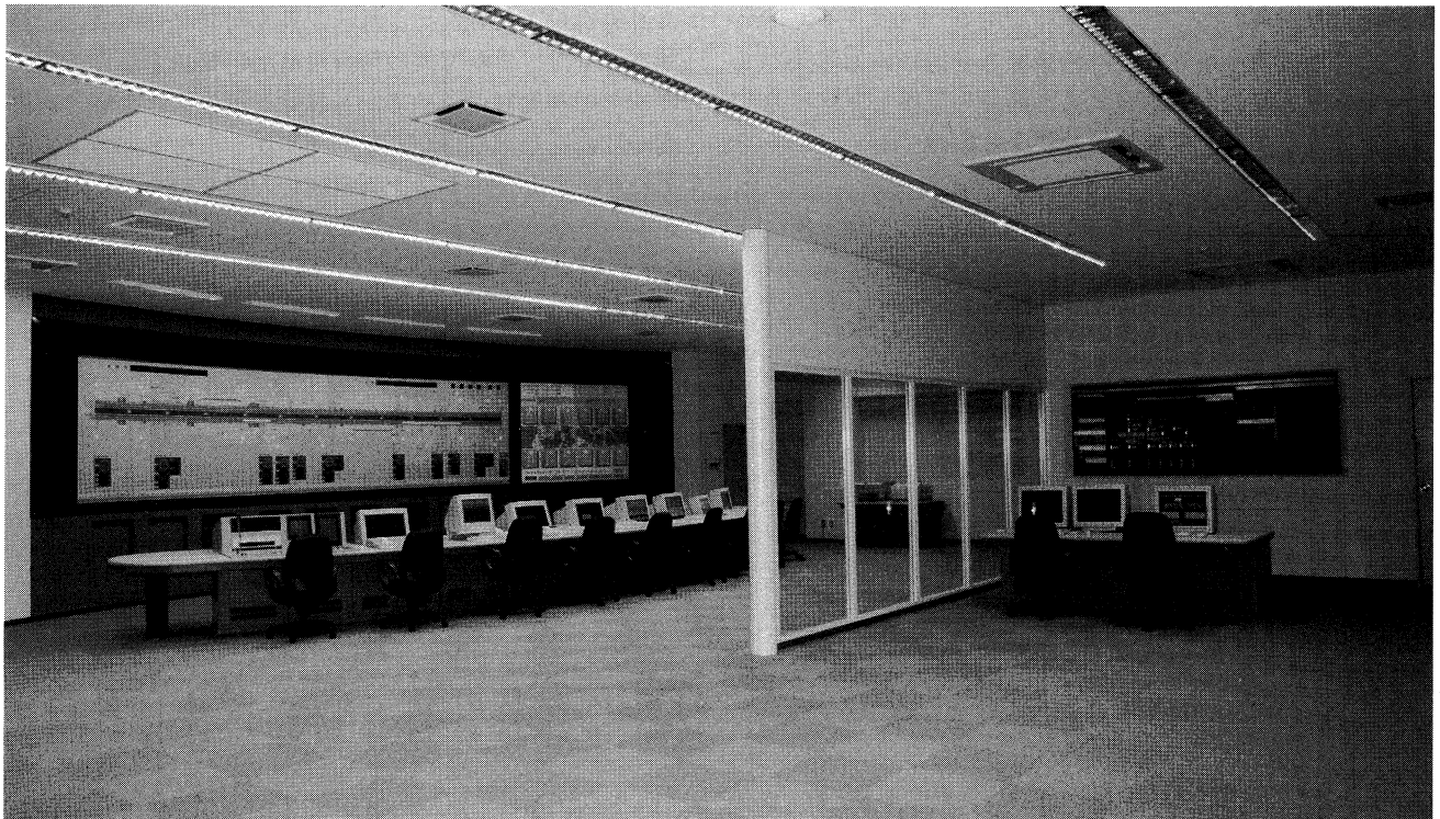
写真-1 交通管制室、施設監視室
