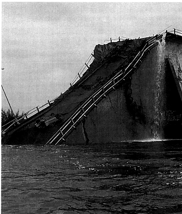
写真-2 崩落直後 車の転落 送水管の破裂
