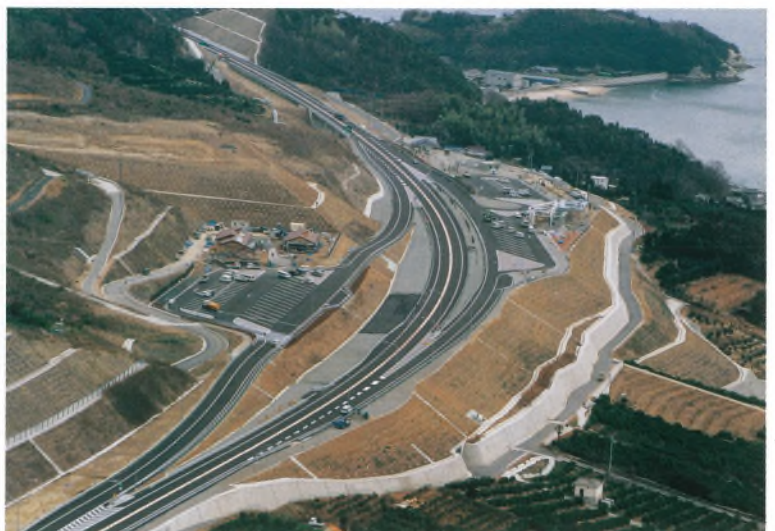
瀬戸田PA工事現況(2P塔頂) (平成11年 3月11日) Current view of Setoda PA work (2P pylon) (March 11, 1999)
