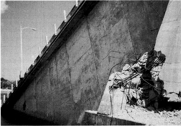
写真-3 海中に没する桁 コンクリートの表面等に注目
