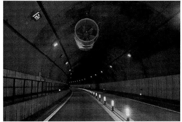
写真一5 宮窪トンネル換気設備
