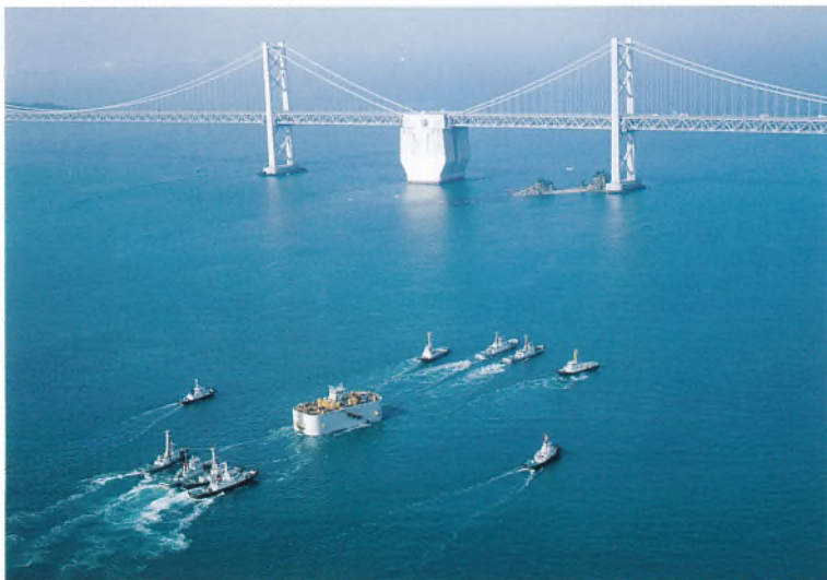
ケーソン輸送状況 (9P主塔基礎) (平成5年1月) Caisson delivery (9 P tower foundation) (January, 1993)
