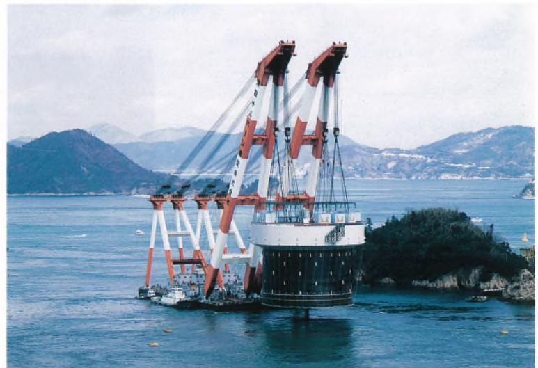
ケーソン設置状況 (5P主塔基礎) (平成5年5月) Setting of caisson (5 P tower foundation) (May, 1993)
