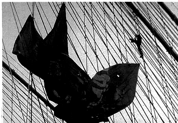
写真-4 ブルックリン橋 ステイワイヤーの破断 Photo.4 Breakage of stay wire on Brooklyn Bridge
