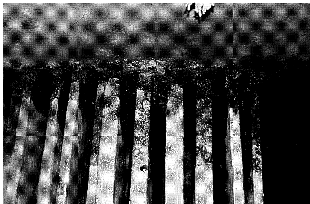
写真-11 ウィリアムズバーグ橋 ストランド定着部断面欠損(AS工法) Photo.11 Loss of section at tension members(AS method)of Williamsburg Bridge
