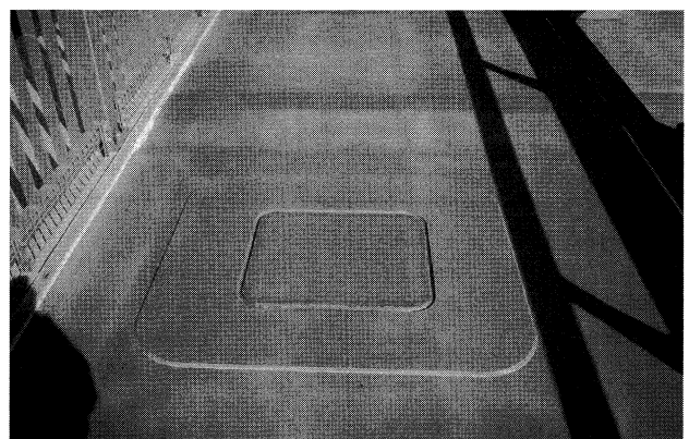
写真-2 鋼床版上面ダブリング補強
