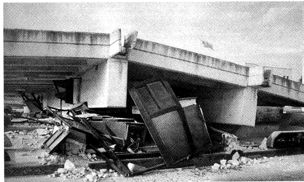
写真-4 料金所上屋の崩壊
