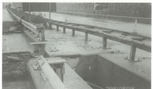
写真-2(1) 上部工がずれた Sakaruya 橋
