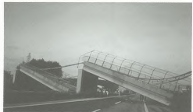
写真-1 落した Arifiye 跨道路橋 写真右端に道路と平行する形で断層があり約 2m 開口した。
