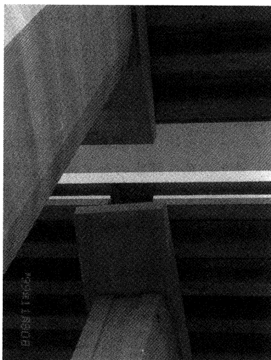
写真一6(4) Viaduct 1 の橋脚の水平面内の回転 地割れが生じた径間の両側の橋脚が水平面内で回転を生じた。 Photo.6(4) Rotational displacement of pier of Viaduct 1
