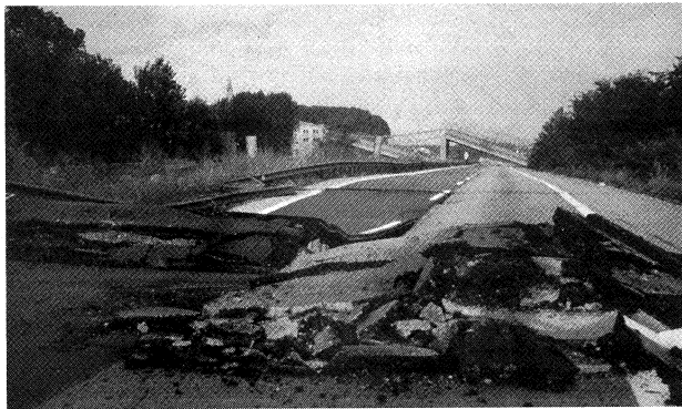
写真-3 道路面の隆起・われ
