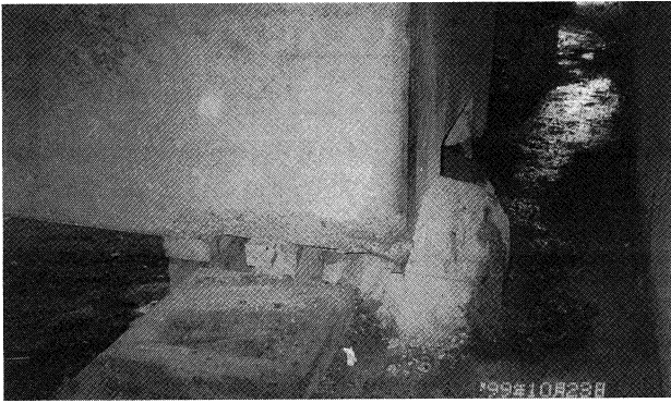
写真-2(2) 上部工がずれた Sakaruya 橋 シアーカーが壊れ、沓座から桁が完全にはずれている。
