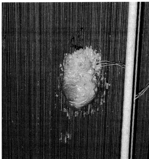
写真-2 ケーブル温度計の設置状況
