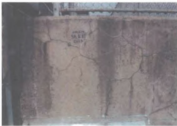
写真-2 大三島橋 3 A の亀甲状ひび割れ
