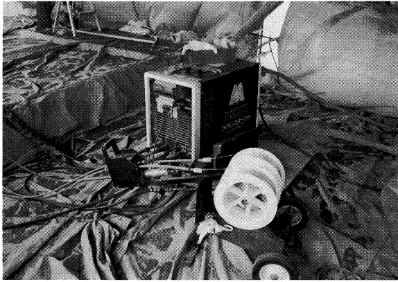
写真-7 チタン溶射設備
