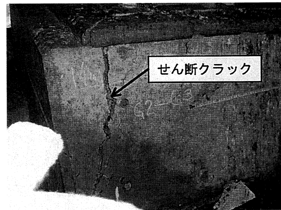
写真-3 4P 北側コンクリート台座の割れ
