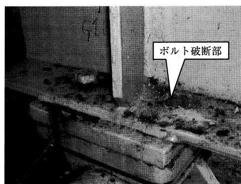
写真-7 上沓セットボルトの破断 Photo.7 Sheared set bolt of upper bearing
