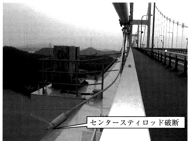
写真-1 センタースティロッド破断状況
