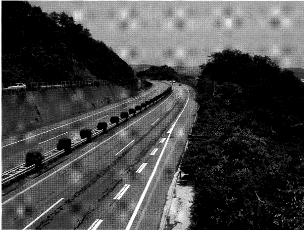
写真-2 児島地区の再補修前 (わだち部の文様がひび割れに施したシール)
