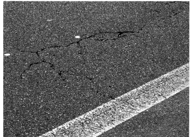
写真-3 変状の詳細 (KP.20.10 付近)
