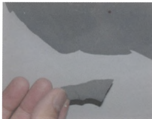
写真-2 無機ジンク層内での剥離
