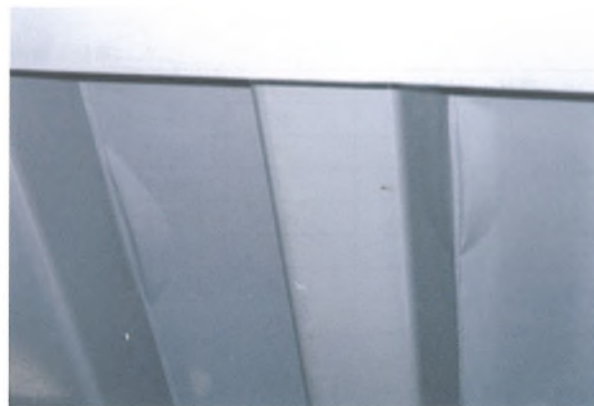
写真-1 鋼床版裏面の膨れ
