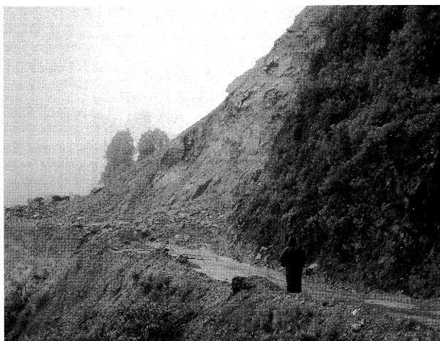
写真-1 法面崩壊による通行止め
