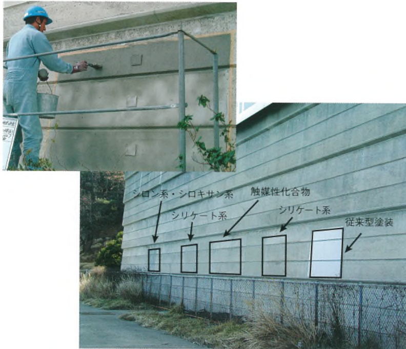
写真—3 コンクリート構造物への含浸剤塗布（下津井瀬戸大橋 3 P）
