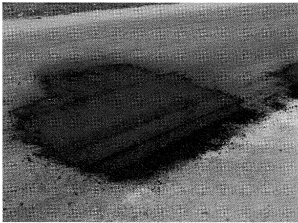
写真-3 現行のポットホール補修例
