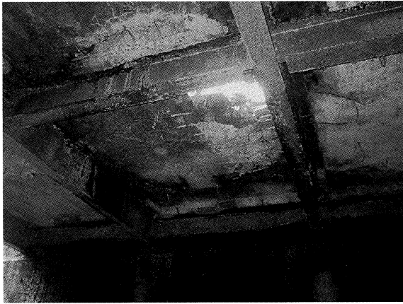
写真-6 路面の陥没。RC床版が破損、陥没し、補修したものがさらに陥没している。砂利のようなコンクリート片から鉄筋がのぞいている
