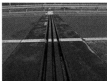
写真-6 損傷状況 (ビームの蛇行)
