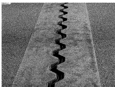
写真-7 損傷状況（止水ラバーの剥がれ） photo.7 Damage (peeling-off of rubber)
