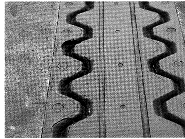
写真-1 損傷状況(破れ、浮き)
