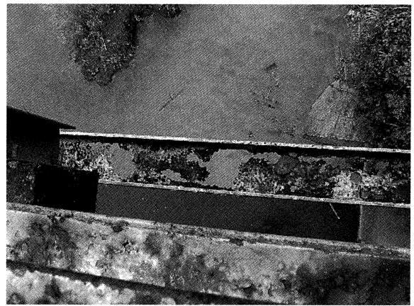
写真-4 鋼トラス桁の下弦材の腐食、断面欠損。同様な損傷は、支承、下横構、橋門構にも見られる。海岸に近い鋼トラス橋では、上横構や上弦材の腐食も観察される
