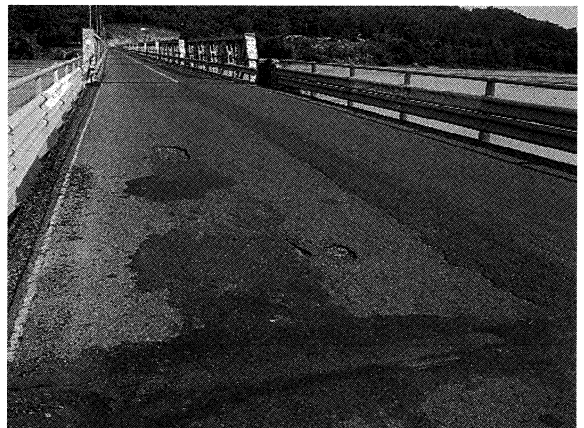
写真-5 鋼床版桁橋の路面状況。Uリブに沿った縦ひび割れが生じ、舗装が剥離し、ポットホールも生じている。1車線で分離しているので、中央は段差が生じるので舗装の補修をしている
