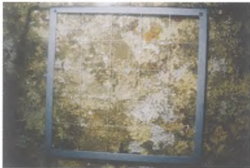
写真-4 電着物の析出状況 photo.4 Depositing situation
