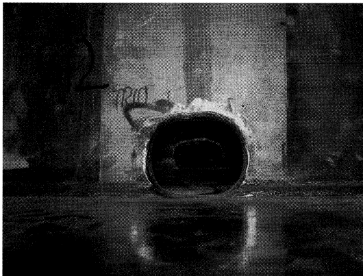
写真-9 縦リブ下端のストップホール
