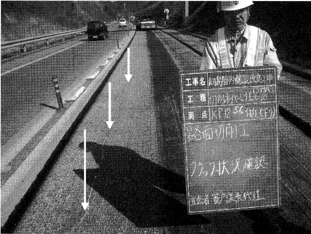
写真一5 As 安定路盤材上面の縦クラックの状況写真 Photo.5 Longitudinal crack on the stabilized base
