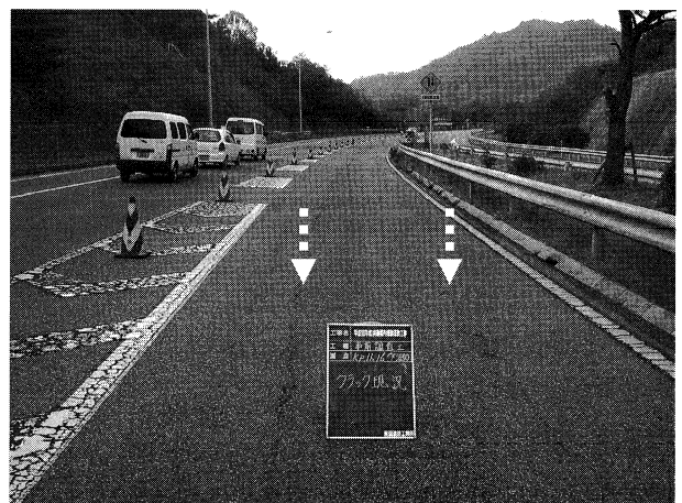
写真-2 わだち部線状クラックの状況写真
