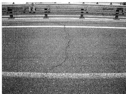
写真-3 与島橋の横断方向ひび割れ
