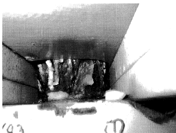
写真-4 定着部付近の腐食
