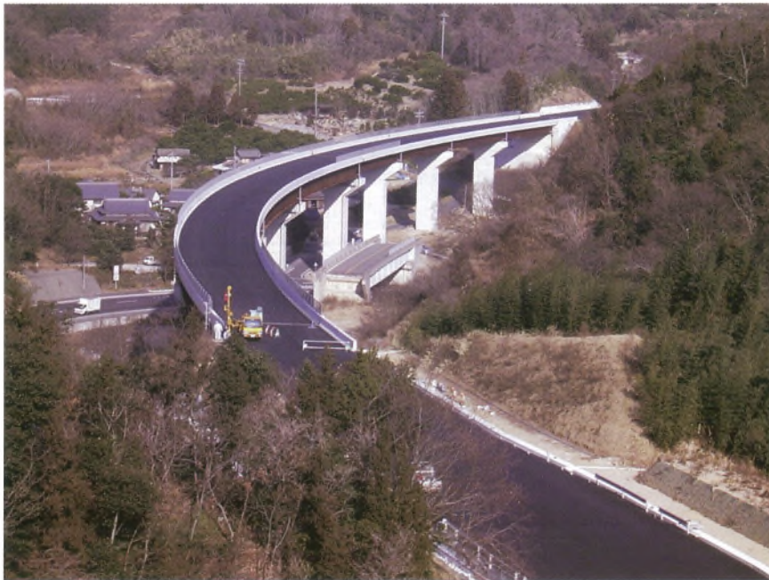
写真—7 大島道路山田橋付近施工状況（国土交通省 四国地方整備局 松山河川国道事務所） Photo.7 Route 317 (Ohshima) Yamada Bridge (Matsuyama Office of River and National Highway, MLT)
