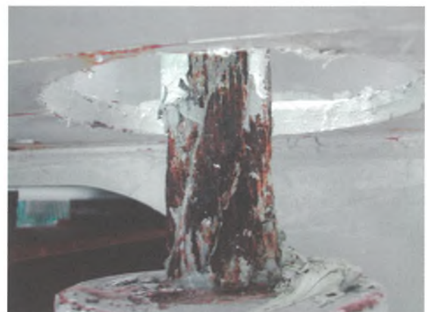
写真-1 ハンガーロープソケット口部部の腐食
