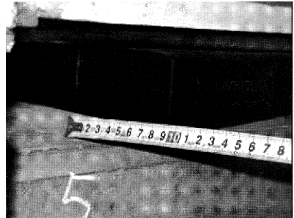
写真-2 支承の変状（支間中央に 90 mm 迫り出している）
