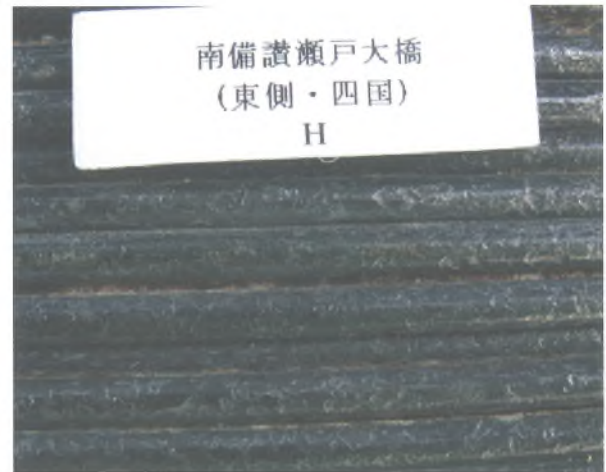
写真-6 素線の孔食状況 (H 17) (南備讃瀬戸大橋 東ケーブル 格点 73-74)
