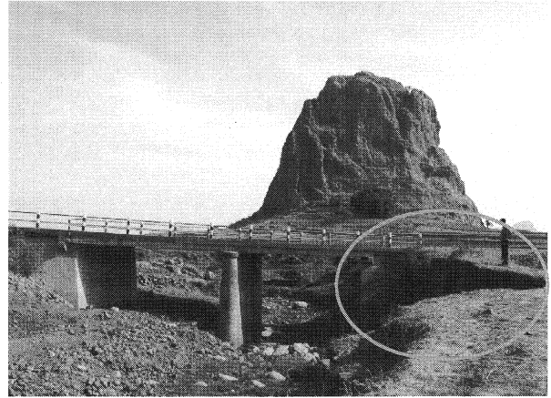
写真-1 橋の損傷（浸食）
