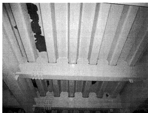
写真-1 鋼床版裏面の塗膜剥離
