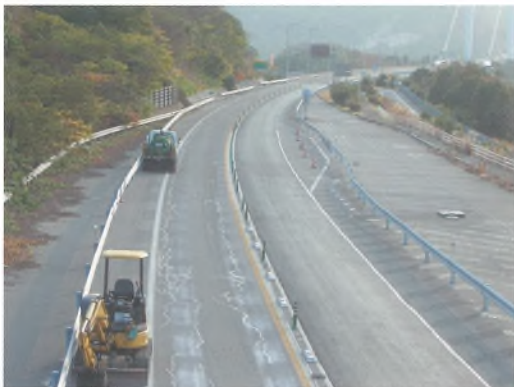
巻頭写真-49 路面変状状況 Opening photo.49 Condition of surface deformation ※ P 71 参照 (See page 71.)
