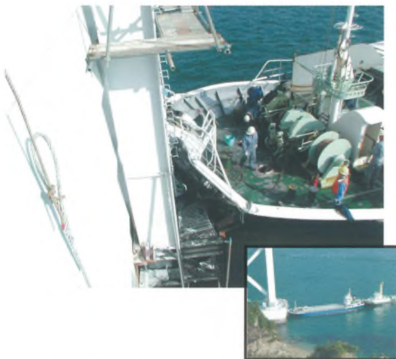
巻頭写真-15 北備讃瀬戸大橋 3P 緩衝工への船舶衝突事故 (2001) Opening photo.15 Ship collision to the buffer of KitaBisan-Seto Bridge 3P ※ P 53 参照 (See page 53.)
