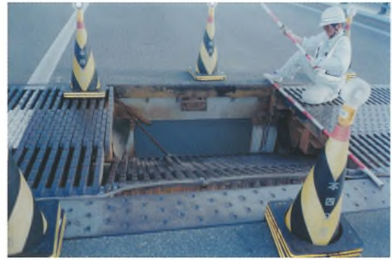
巻頭写真-12 リンク式伸縮装置傾斜による路面陥没(1994) Opening photo.12 Falling down of link type expansion joint ※ P 9、53 参照 (See page 9, 53.)
