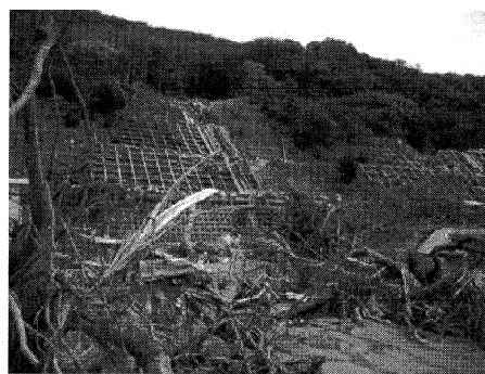
写真-3 H16年度災害の状況(室津PA)
