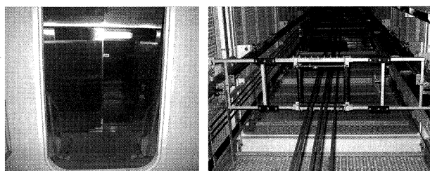
写真-5 吊橋主塔エレベータの乗場と主ロープ振止装置
