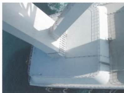
巻頭写真-23 マスコンクリートの塩害対策 (主塔基礎頂版表面被覆)
