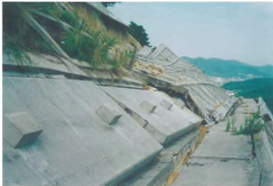
巻頭写真-11 福江地区のり面崩壊 (1990) Opening photo.11 Collapse of the slope around Fukue ※ P 15 参照 (See page 15.)
