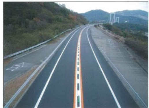
巻頭写真-50 高機能舗装舗設完了 Opening photo.50 Completion of high performance pavement ※ P 71 参照 (See page 71.)
