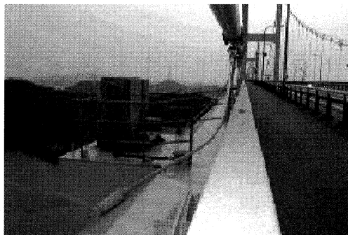
写真二 芸予地震時の状況 (来島海峡大橋センターステアロッドの破断)
