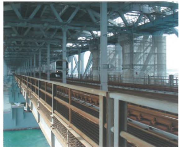
巻頭写真-16 瀬戸大橋の本格的な全面塗替塗装開始 (2006~) Opening photo.16 Starting of the repainting work ※ P 9、43 参照 (See page 9, 43.)
