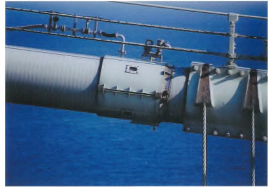
巻頭写真-18 主ケーブル送気乾燥システム (送気 カバー) Opening photo.18 Dry air injection system (injection cover) ※ P 35、73 参照 (See page 35, 73.)
