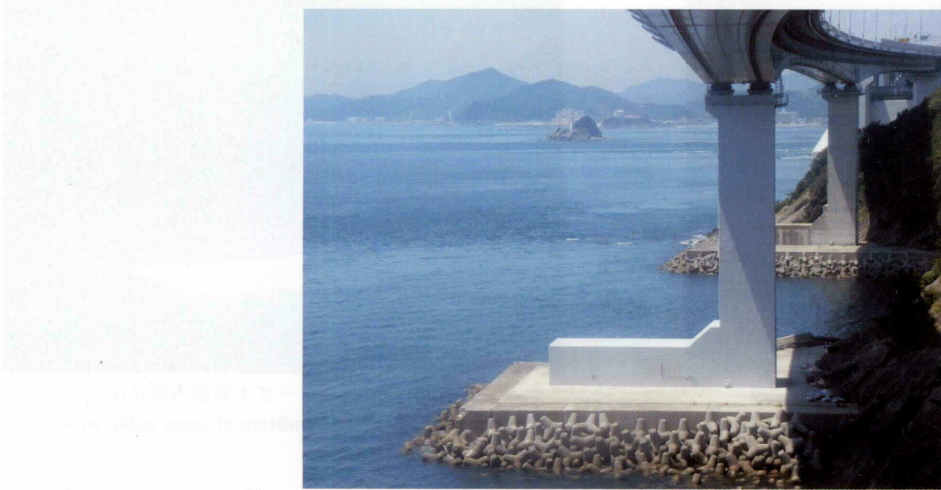
巻頭写真-1 コンクリート橋脚防食工完了（神戸側から鳴門側を見る）
