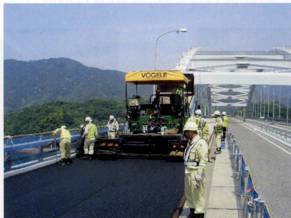
巻頭写真-10 碎石マスティックアスファルト舗設状況 Opening Photo 10 Laying of crushed mastic asphalt
