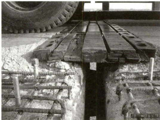
写真-6 伸縮装置下のコンクリートの破壊
