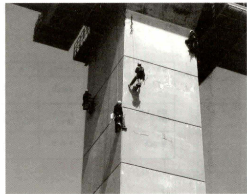
写真-4 ロープアクセスによる打音調査 Photo 4 Tapping inspection by rope access
