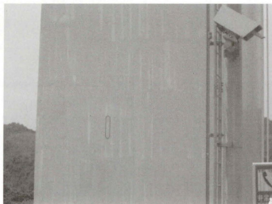
写真-1 主塔の塗装面
