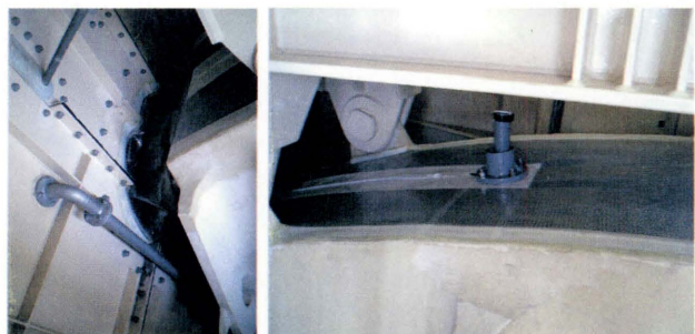
(a)サドルカバー部の隙間対策 (b)防湿シートと排気口 写真-4 塔頂サドル部の気密化 Photo 4 Air-tightness of tower saddle
