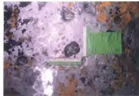
写真-1 孔食状況（岩黒島橋 IB2P、中央の孔食径 \phi 40 ）
