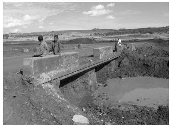
写真-6 土砂が堆積した橋 Photo 6 Sedimentation under Bridge
