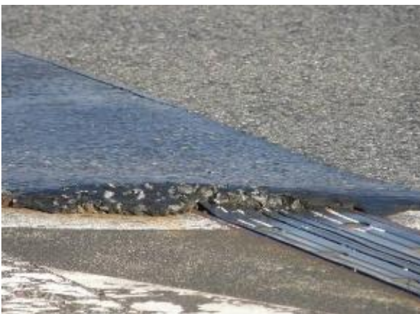
写真-2 流動化わだち (拡大写真)
