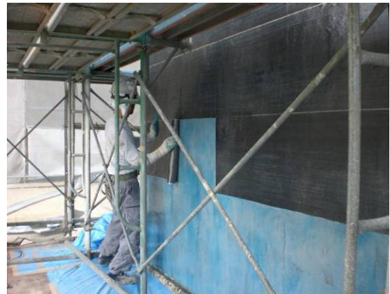
写真-2 炭素繊維シート貼付け状況 (2P) Photo2 Pier retrofit using carbon-fiber sheets (2P)
