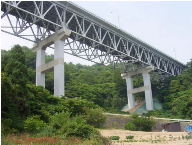
写真-8 炭素繊維シートによる橋脚補強完了 Completion of the pier retrofitting with carbon-fiber sheets
