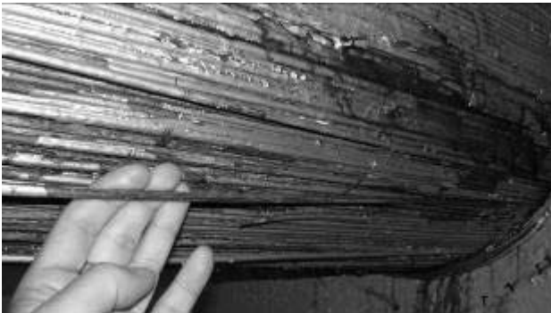
写真-17 破断したワイヤー（アンカレイジ内） Photo-17 A broken wire in an anchorage
