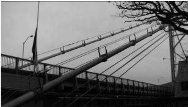
写真-18 側径間部補強ケーブル（主ケーブルの下） Photo-18 A main cable with reinforcing ropes (beneath the cable)
