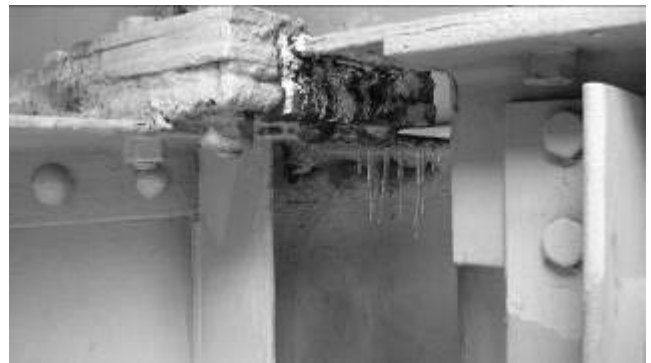
写真-16 床版縦桁支承の塗装後の発錆
