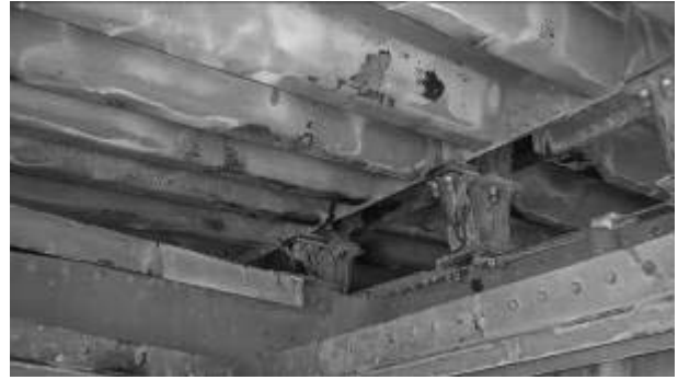
写真-3 鋼床版裏面の腐食の補修状況（北高架橋）
