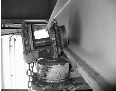
写真-5 点検作業車 Photo 5 Inspection Gantry
