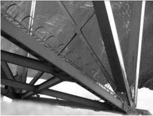
写真-20 トラス部材の発錆状況 Photo-20 Rust on truss members
