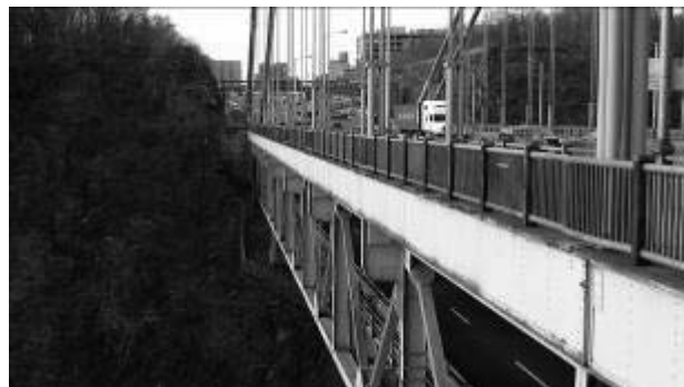
写真-13 トラス桁部エッジ部の錆
