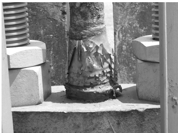
写真-6 ハンガーロープ定着部の抜け Photo 6 Hangar Rope Displacement from Socket
