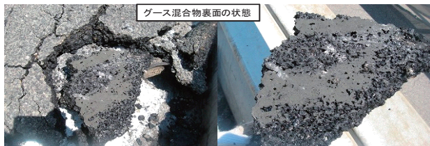
図-9 健全部におけるグース下面の異常
