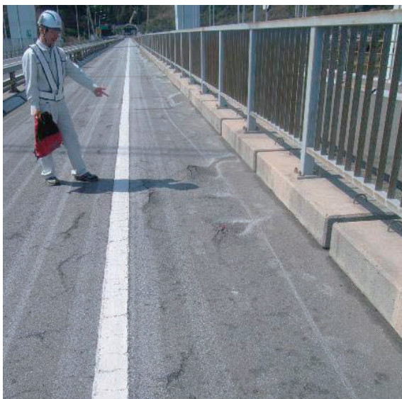
写真-7 橋面舗装のプリスタリング(原自歩道部) Pavement blistering
