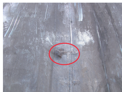
写真-4 吊ピース切断部の錆
