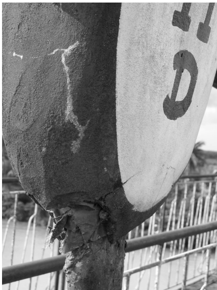
写真-3 ケーブルバンドの防食状況 Photo 3 Corrosion Protection of Cable Band
