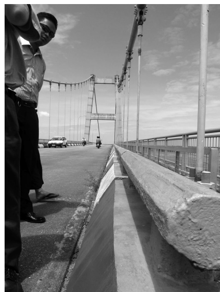
写真-5 キャンバーの状態 Photo 5 Camber of Twantay Bridge
