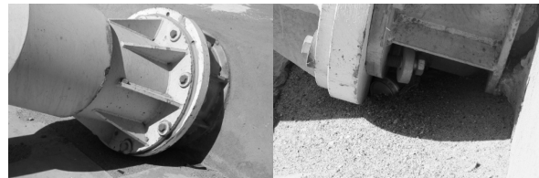
写真-10 床版定着部ボルトの緩み Photo 10 Loosened Bolt of Deck Slab Anchorage Zone
